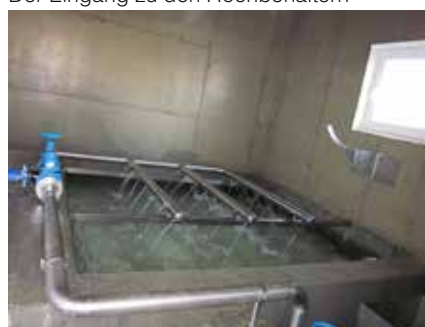
Entsäuerungsanlage mit Zulauf zum mit Marmorquarz gefüllten Filtrationsbecken
