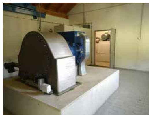
Trinkwasserturbine Knottberg (vorne, maximale Leistung = 220 kW) und Orgles (hinten, maximale Leistung = 23 kW)
