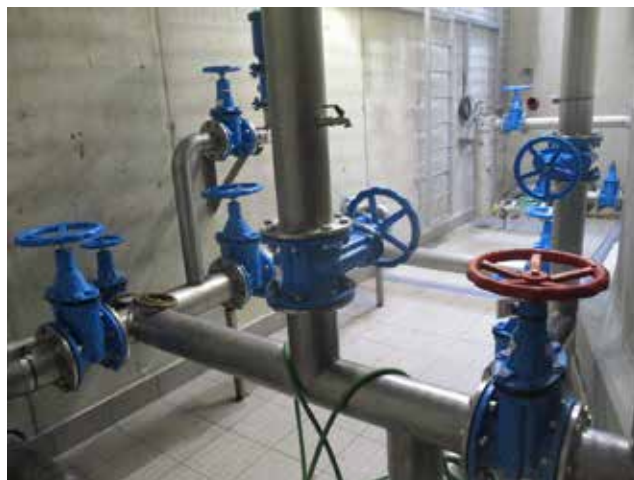
Armaturen im Hochbehälter
