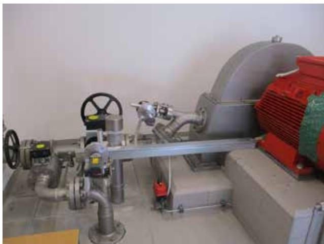
Turbine, Bypass und Generator des Trinkwasserkraftwerkes
