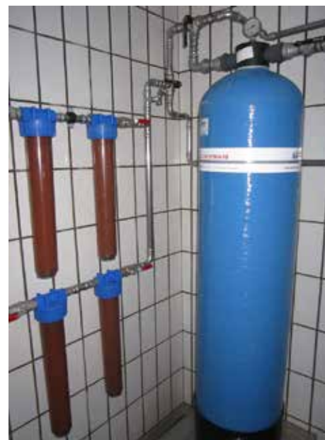
Uranaufbereitungsanlage im Hochbehälter Ulten/Alsack
