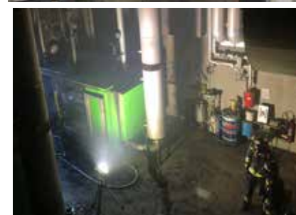
Alcuni spaccati inerenti l'incendio presso la centrale del teleriscaldamento
