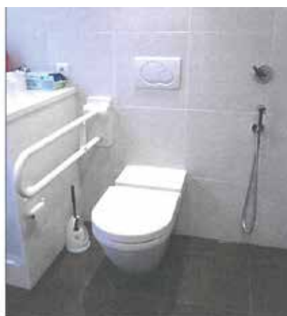
WC mit Stützklappgriff und WC-Brause
